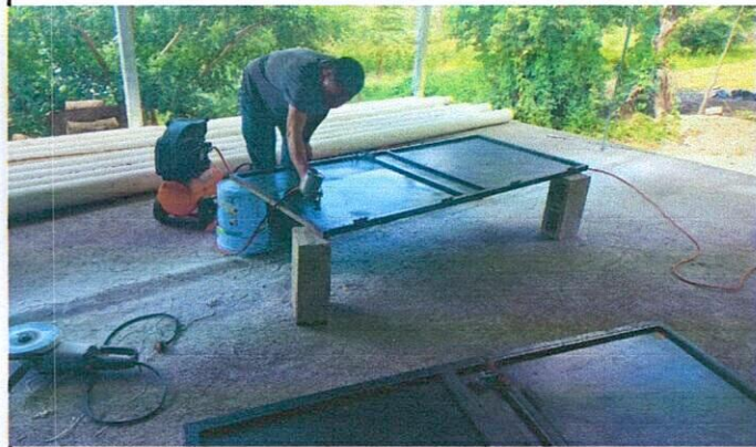
Foto 3: Mejoramiento y reparación de puertas y ventanas de aula, dirección y bodega.
